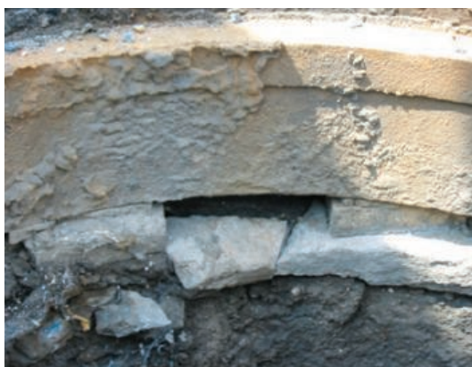
Zničená maltová spára
